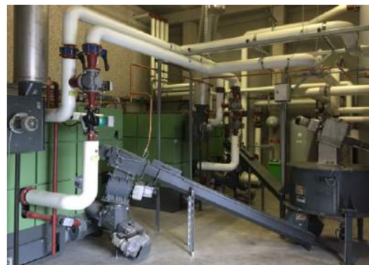
Die Beschickung der beiden Kessel wird von einem zentralen Behälter aus mit Hackschnitzeln versorgt.
