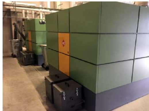
Zwei HDG M400 Hackschnitzelheizungen sorgen im Kaskadenbetrieb zuverlässig für konstante Temperaturen in der Lagerhalle am Hafen Rotterdam.
